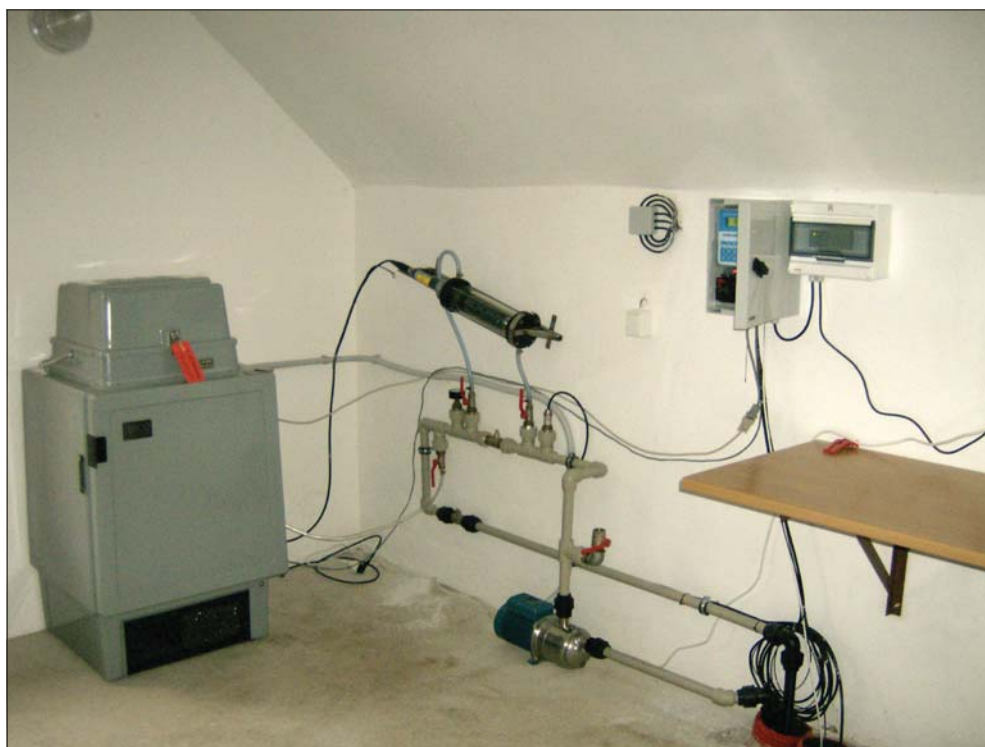
Obr. V.13 Instalovaný systém ve stanici Terežín. Fig. V.13 Installed system at Terežín station.
