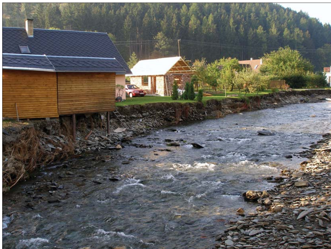
Obr. V.8 Břehové nátrže na Opavici v Holčovicích.
