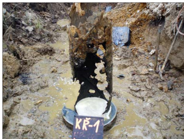
d) Křesín Kř-1 (zrezivělá pažnice / rusted casing pipe ).
