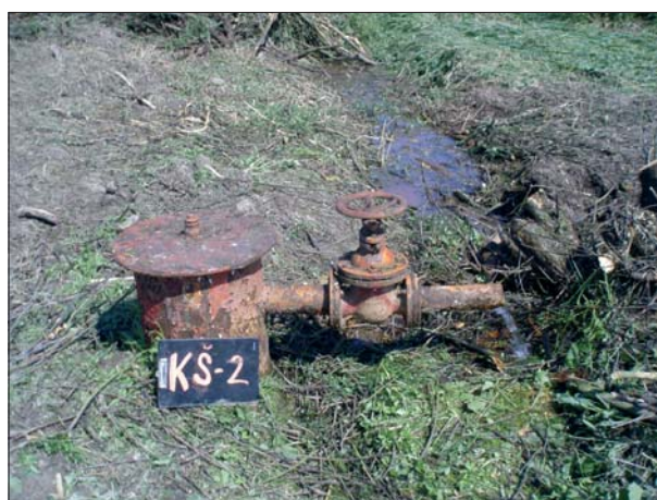
d) Kojovice Kš-2 (únik zrezivělým zhlavím / leaking from rusted well head).
