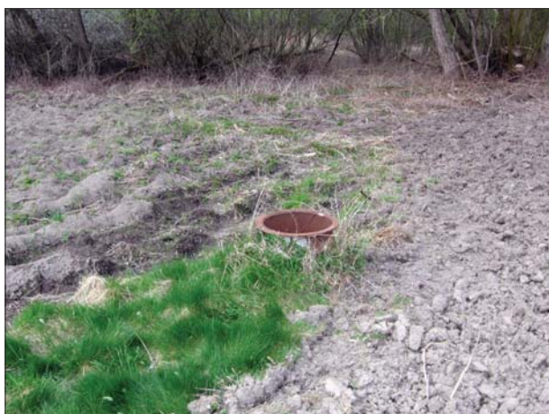
c) Velký Borek PŠS-7 (chybějící hlaví / missing well head ).
