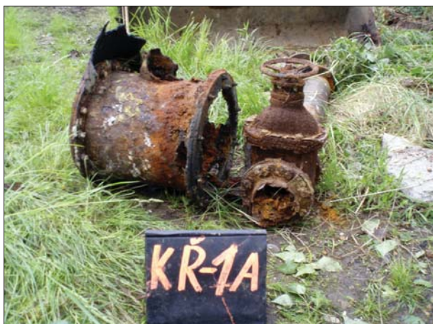
a) Křesín Kř-1a (zrezivělé zhlaví / rusted well head ).
