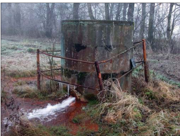
c) Počedělice L-3 (přetok z prasklého zhlaví cca 4 \text{ l.s}^{-1} / 4 \text{ l.s}^{-1} overflow from cracked well head).
