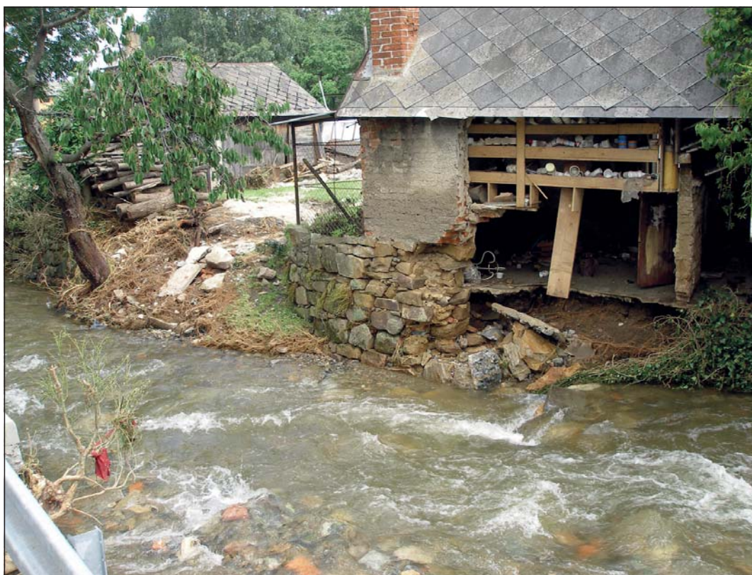
Obr. V.12 Povodňové škody na Skorošickém potoce ve Skorošicích. Fig. V.12 Floods damage on the Skorošický stream at Skorošice.
