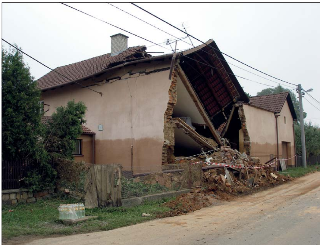
Obr. V.11 Povodňové škody na Luze v Jeseníku nad Odrou. Fig. V.11 Floods damage on the Luha stream at Jeseník nad Odrou.
