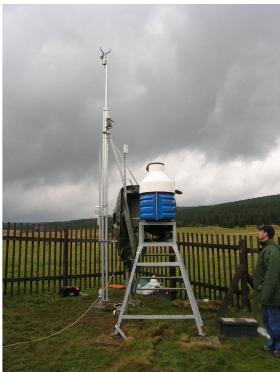
6.13 Na klimatické stanici Jizerka je nově instalován srážkoměr MRW 500 (Meteoservis Vodňany). Jedná se o váhový srážkoměr určený k měření kapalných i tuhých srážek.
