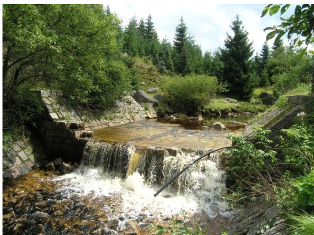
6.23 Zničená úprava toku na Černé Smědě
