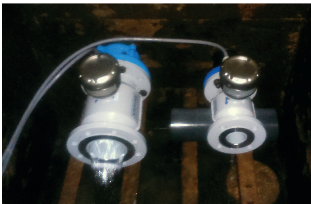
Obr. V.8 Průtokoměry na pramenech PP0279 Častrov a PP0620 Častrov.
